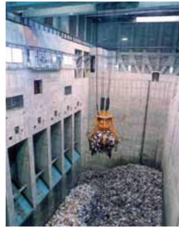
③ごみピットとごみクレーン ごみを一時的に貯留し、ごみクレーンでごみを焼却炉へ運びます。
