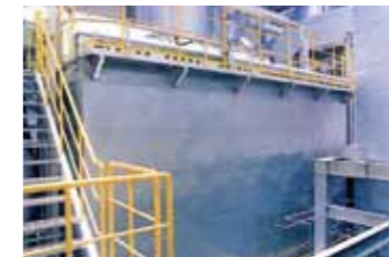
⑨バグフィルタ 約150℃に下げられた排ガスから、ばいじん・ダイオキシン類等の有害ガスを除去します。
