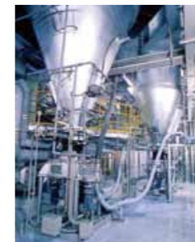
⑧有害ガス除去設備 排ガス中に薬品（消石灰・活性炭）を噴霧して有害物質を除去します。
