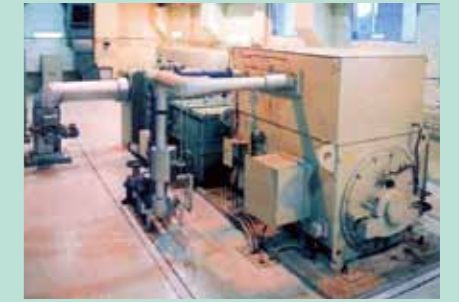
●蒸気タービン発電機 蒸気タービンを稼働させ発電します。発電能力は、6,000kWです。
