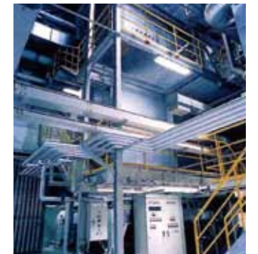
⑩脱硝反応塔 触媒による化学反応を利用して、排ガスから窒素酸化物を除去します。
