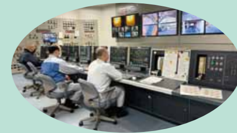
●中央制御室 焼却炉の燃焼制御をはじめ、施設全体の制御・管理を集中的に行っています。
