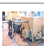
タービン発電機
