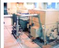
タービン発電機
