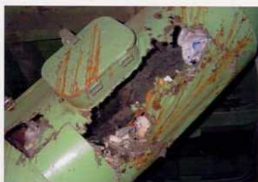
爆発による損傷箇所の一部
