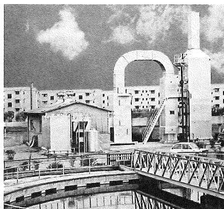
脱臭装置(ケニーK式脱臭装置)
